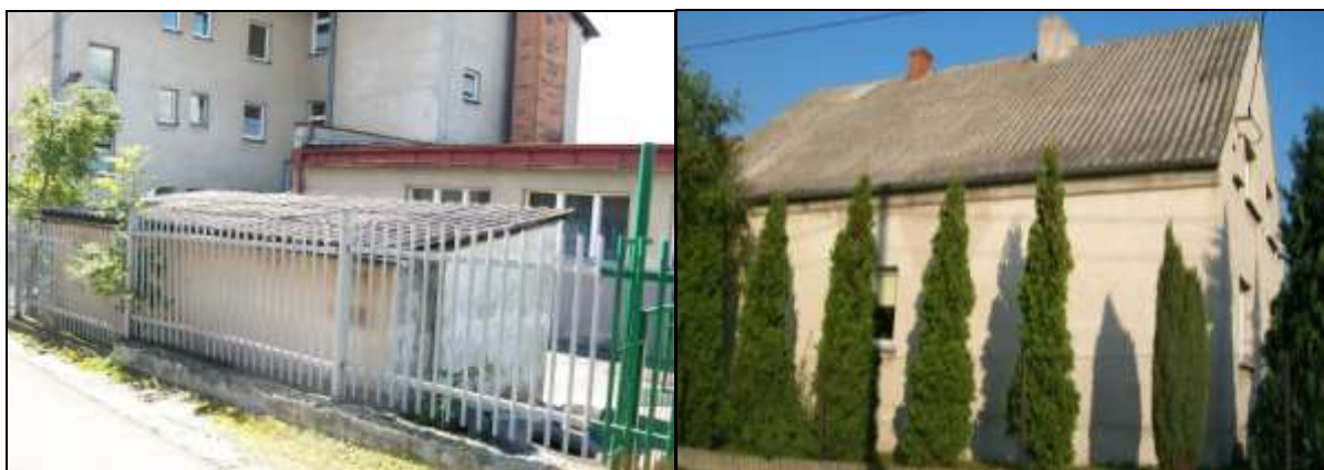
Fot. nr 5 i nr 6. Płyty faliste azbestowo-cementowe
