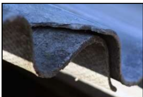
Fot. 1. Pęknięta płyta azbestowa
